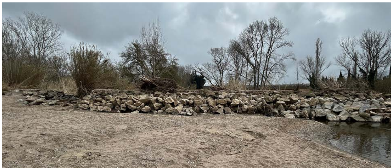
Fig. 7: Vista frontal de la resclosa amb el talús exterior en primer terme. Es pot observar la disposició caòtica dels blocs.
