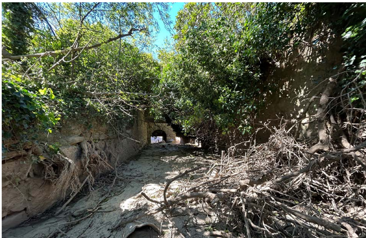
Fig. 28: Vista de l'interior del tram inicial del rec del Molí. Es pot observar la quantitat de restes que colguen l'interior i la vegetació que creix sobre els murs laterals que el delimiten.
