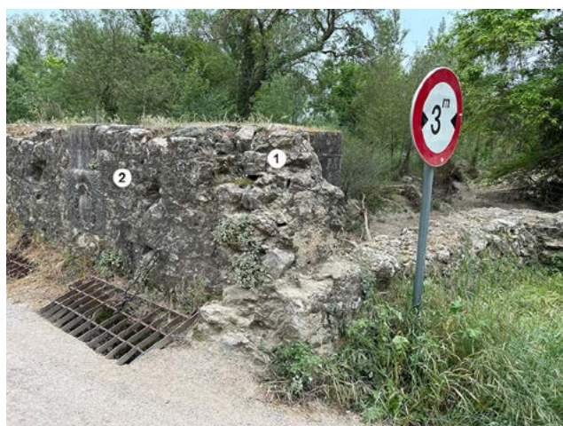
Fig. 50: Vista de la cantonada nord-oest del mur M-7 del cadiral amb la indicació de les patologies de conservació. (1) Part trencada. (2) part del mur col·lonitzada de fongs i líquens.
