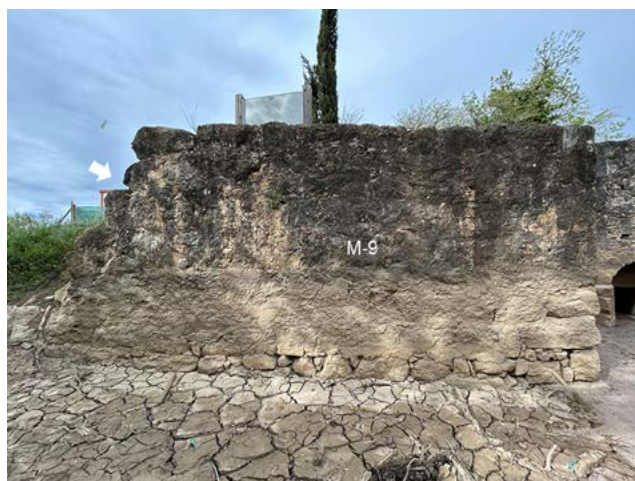
Fig. 17: Vista frontal del mur M-9. A la part esquerra es pot veure com està mal acabat o trencat.
