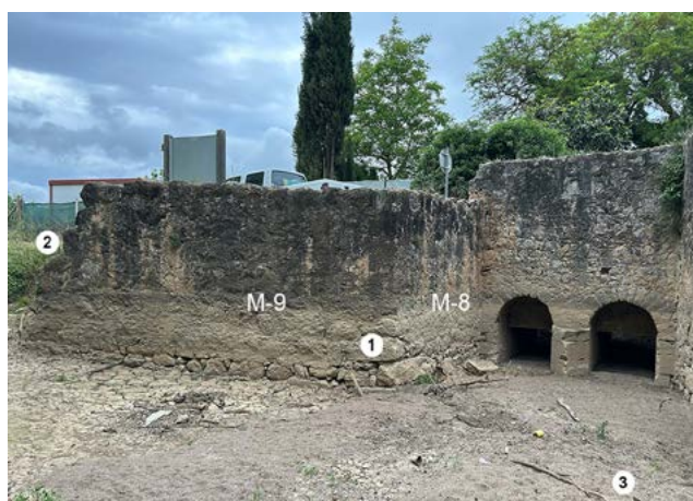
Fig. 49: Punt amb patologies estructurals de la bassa. (1) Juntes sense morter. (2) Part trencada del mur M-9. (3) deixalles acumulades.
