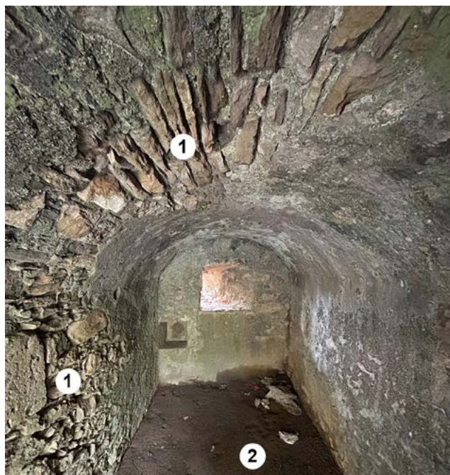
Fig. 54. Interior de l'estança. (1) Punts on s'ha perdut el revestiment interior. (2) terra acumulada i que cobreix el paviment.
