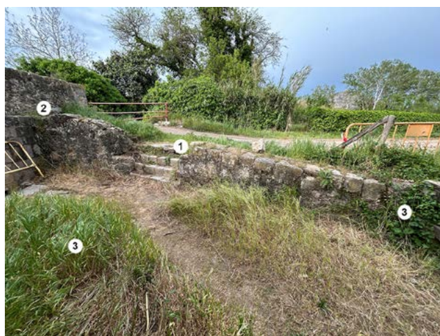
Fig. 52: Vista del pati amb la situació de les patologies. (1) brancal del mur M-1. (2) coronament del mur M-2. (3) vegetació que colonitza tot el pati i terra que cobreix l'enllosat.
