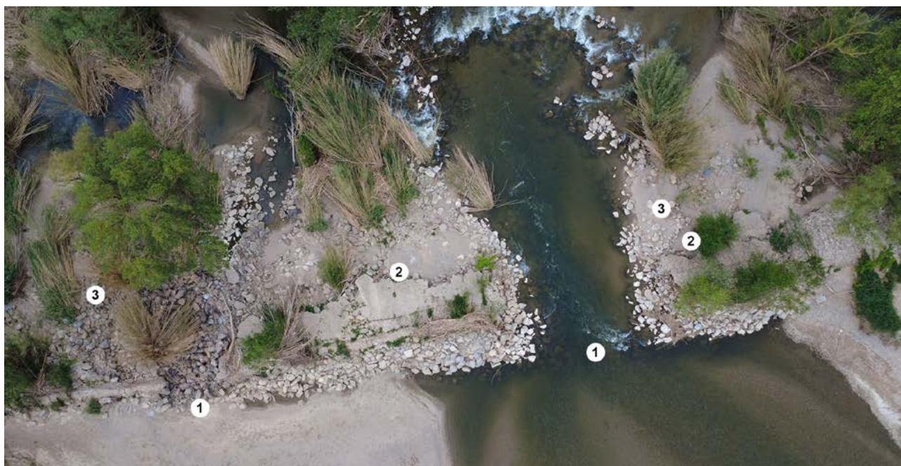
Fig. 48: Vista aèria de la resclosa en el punt dels dos trencaments (1). També es pot observar els punt on el morter del lliscat que recobreix el talús interior s'ha malmès (2) per culpa de la vegetació que hi creix i el desplaçament dels blocs (3).
